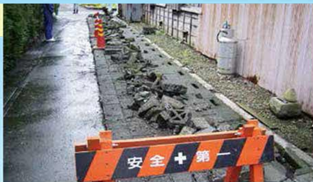
駿河湾沖地震によるブロック塀の倒壊(平成21年8月)
